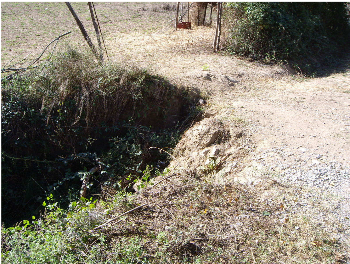
Foto n. 10 – particolare del primo smottamento sulla strada
