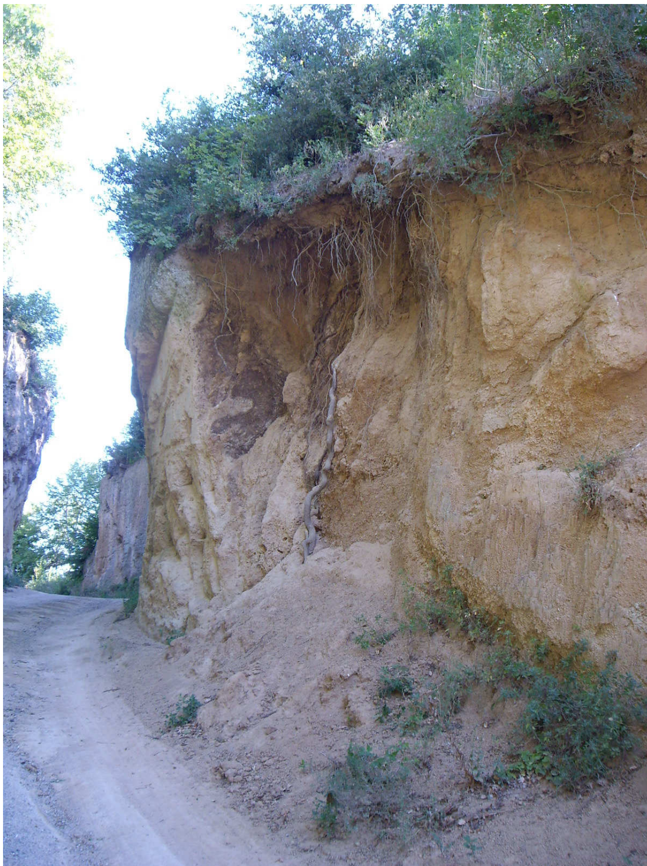
Foto n. 7 – Altro particolare del fenomeno, si evidenzia la pericolosità per il transito
