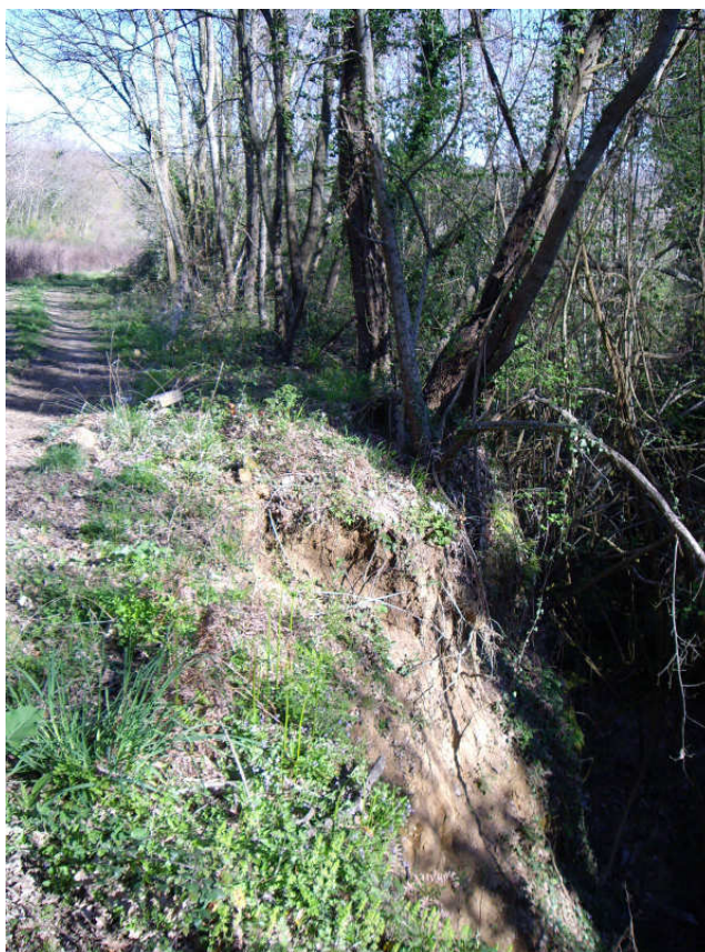
Foto n. 17 – Ciglio superiore della frana , si nota la grande instabilità e la forte pendenza del versante
