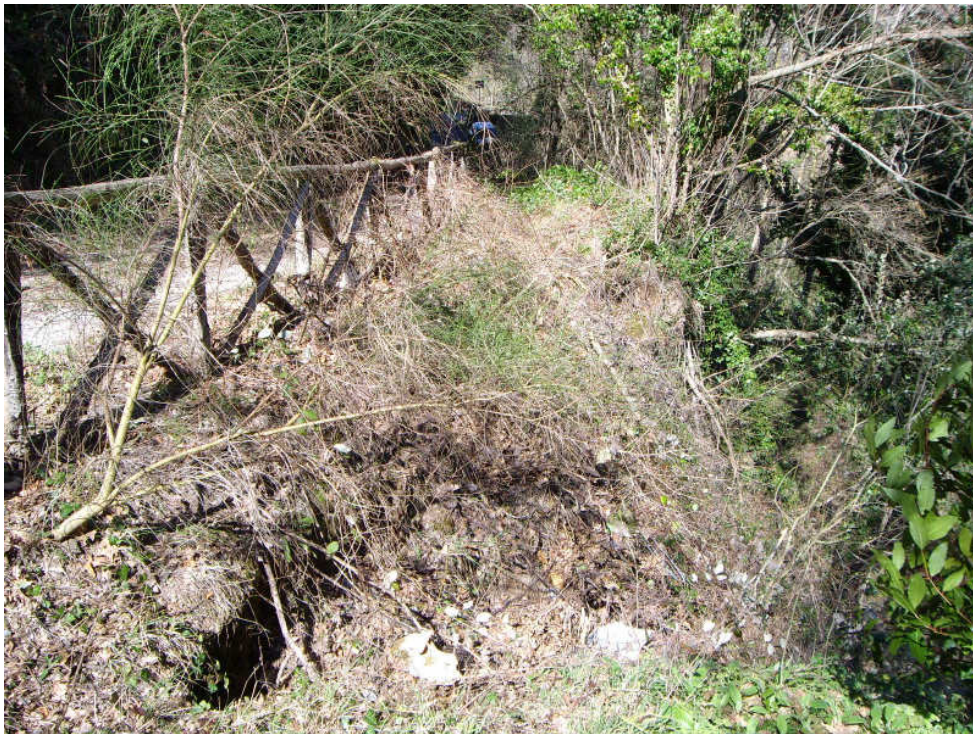
Foto n. 2 – particolare dello smottamento di valle, con staccionata da sostituire
