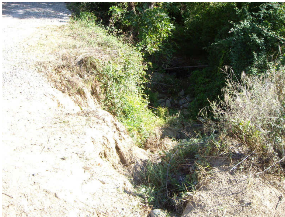
Foto n. 13 – Altro particolare dello smottamento
