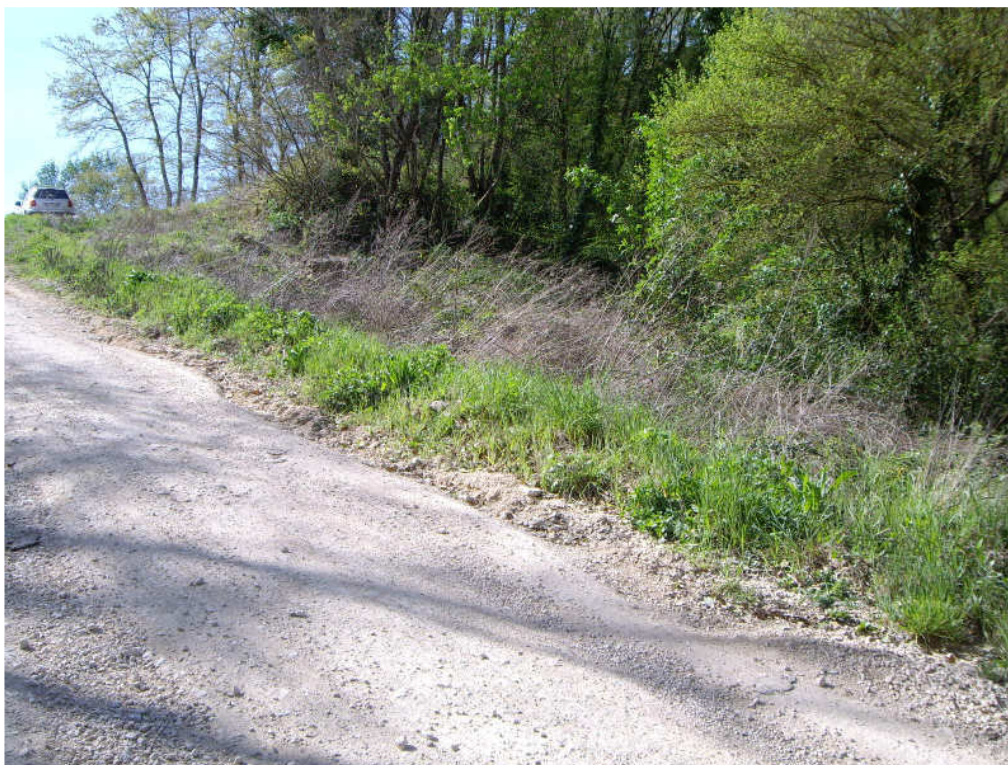
Foto n. 19- smottamento di valle della strada
