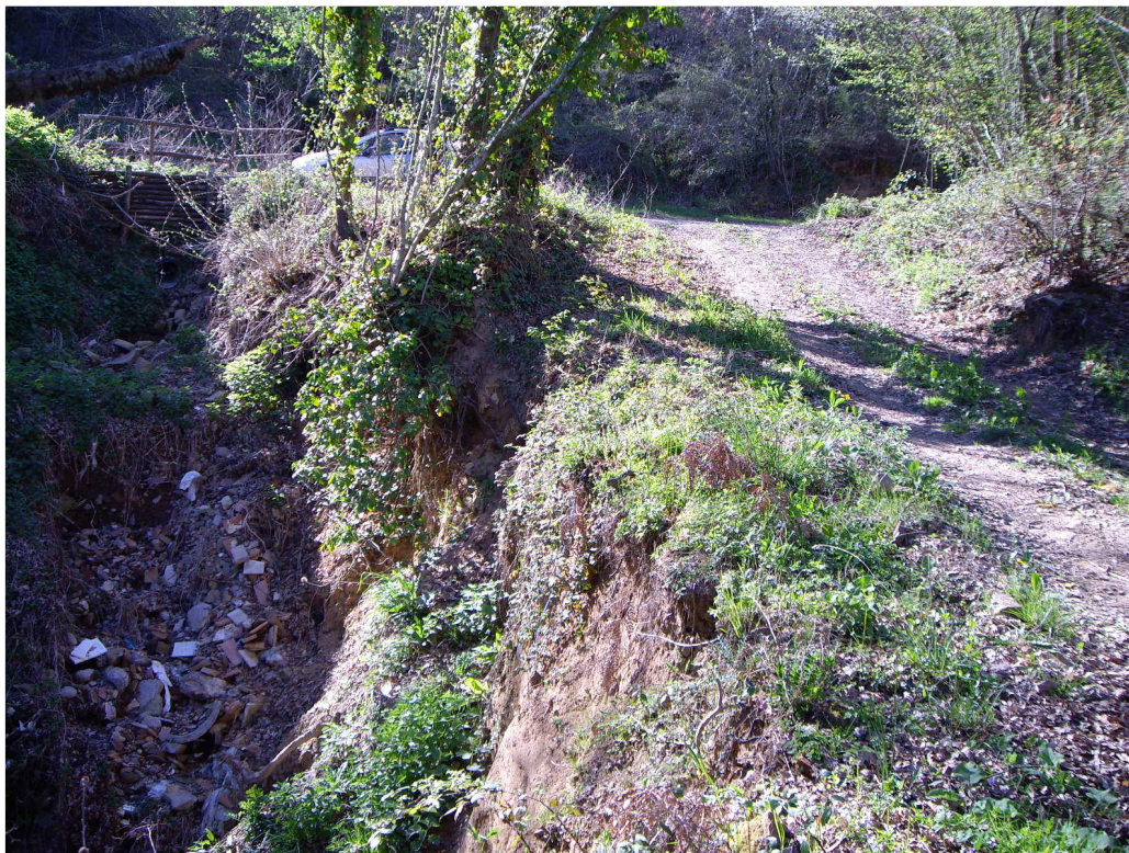
Foto n. 16 – altro particolare della frana dovuta all’erosione di sponda del torrente
