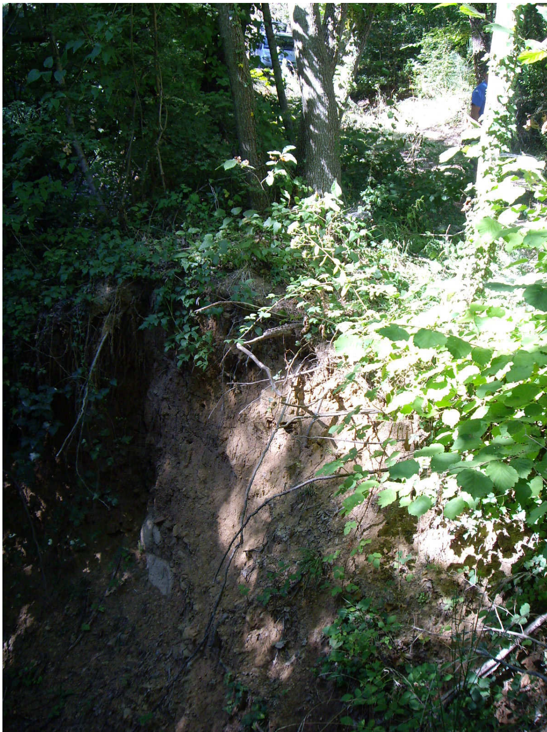
Foto n. 18 – altro smottamento del ciglio del versante più a valle, punto fino a dove realizzare la scogliera a protezione dello stesso e della sponda del torrente
