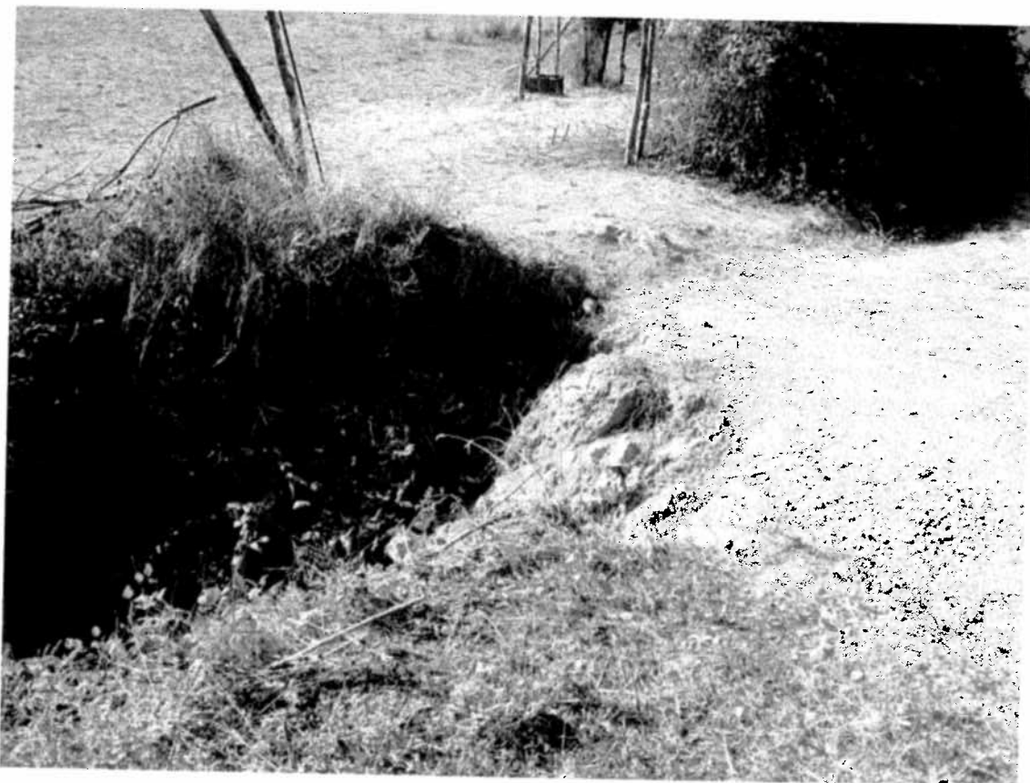
particolare smottamento sulla strada
