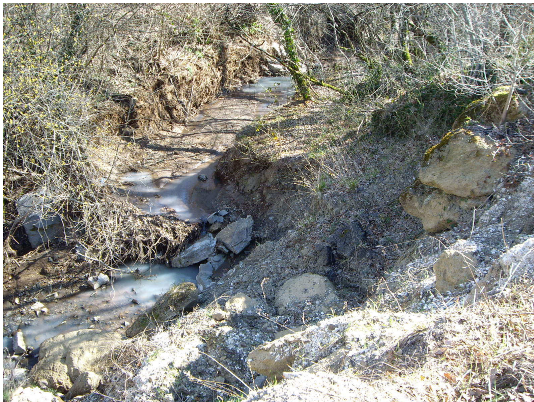
foto n. 8 – comune di Sorano – Poggio Bortolo – erosione in sponda dx dove realizzare scogliera e gabbionata a monte sottostante il ciglio della strada
