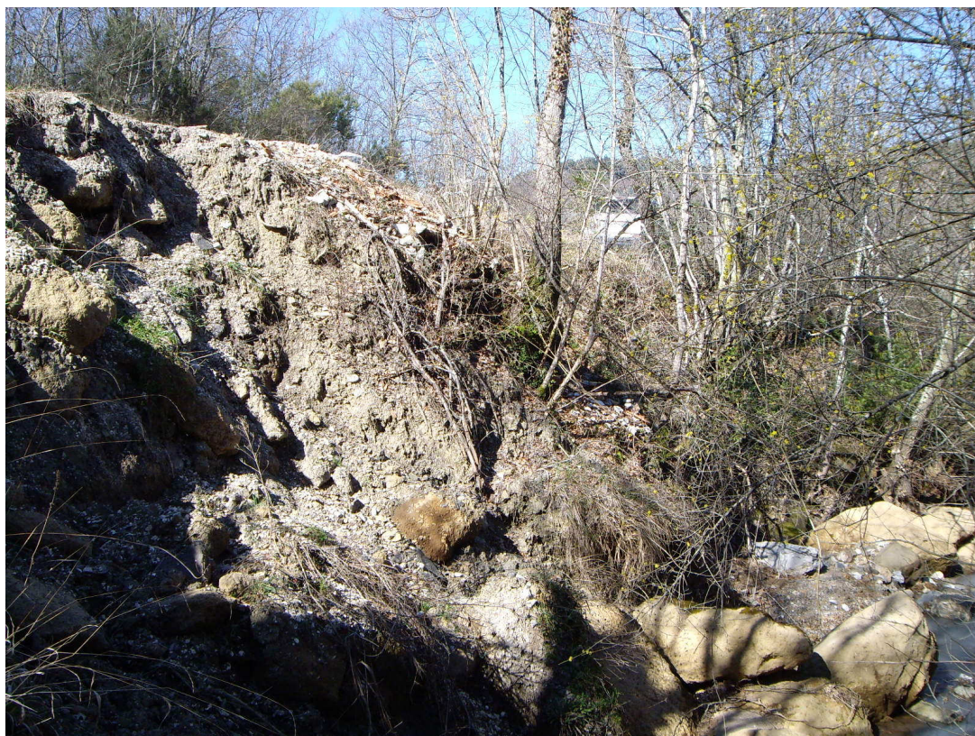
foto n. 10 – comune di Sorano – Poggio Bortolo – altro particolare dell'erosione in curva sponda dx
