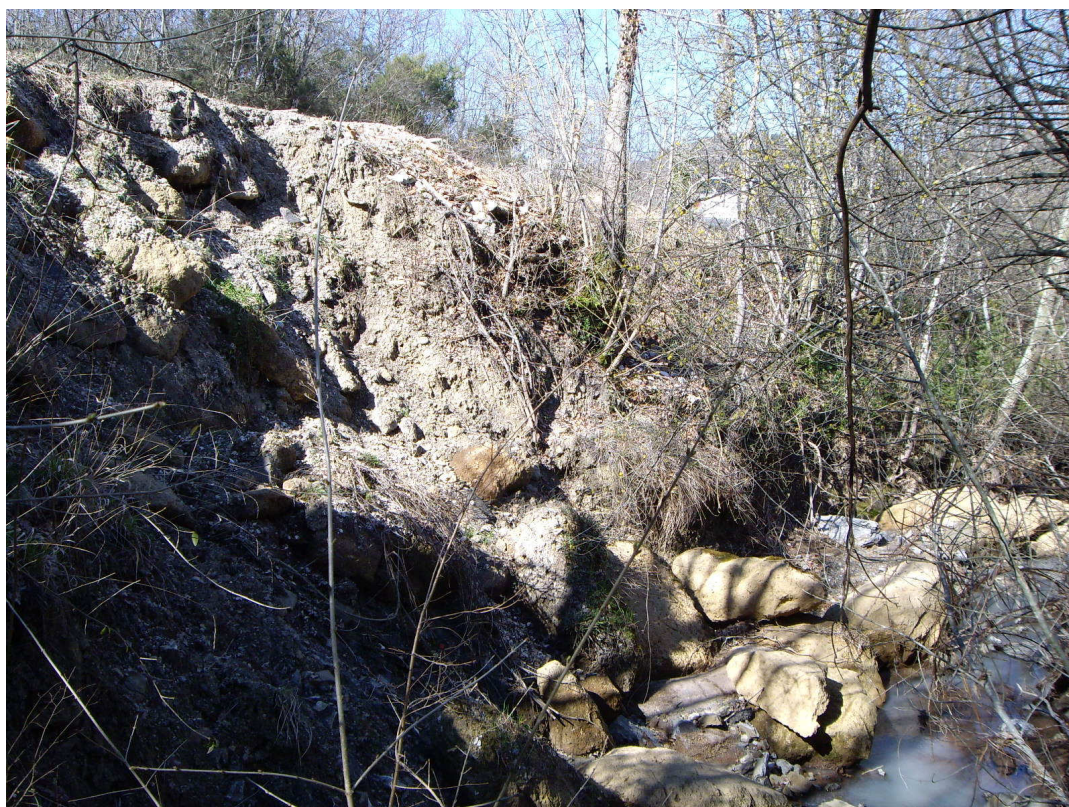
foto n. 9 – comune di Sorano – Poggio Bortolo – altra visione dello smottamento tra il fosso e la strada sovrastante
