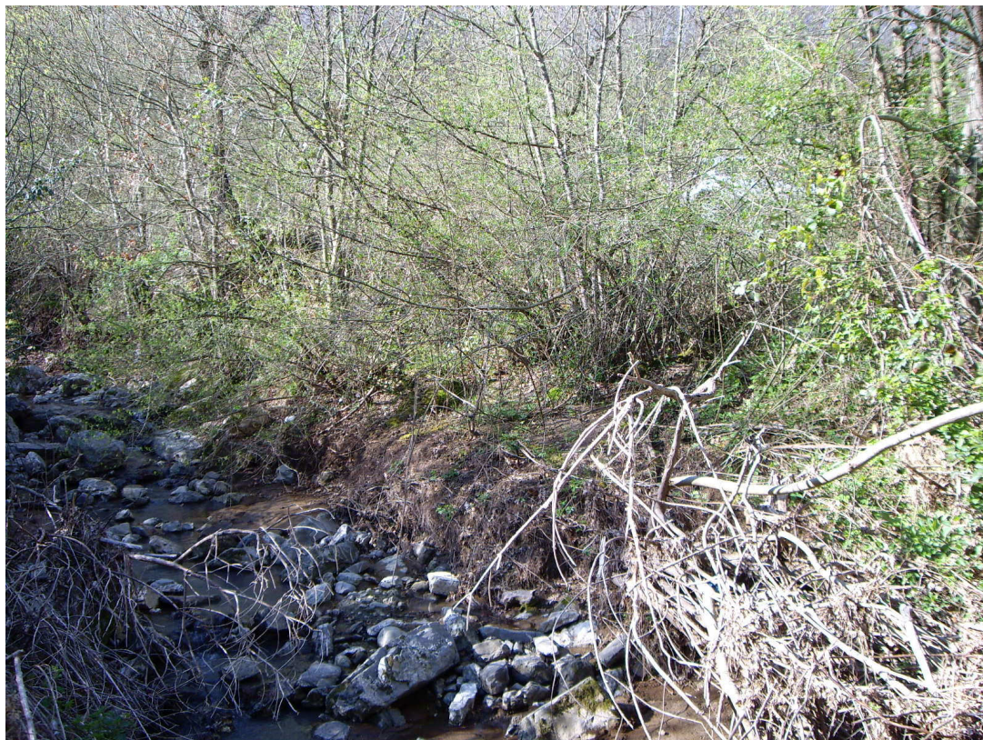
foto n. 15 – comune di Sorano – Poggio Bortolo – erosioni di sponda dove realizzare le palizzate di contenimento, taglio della vegetazione
